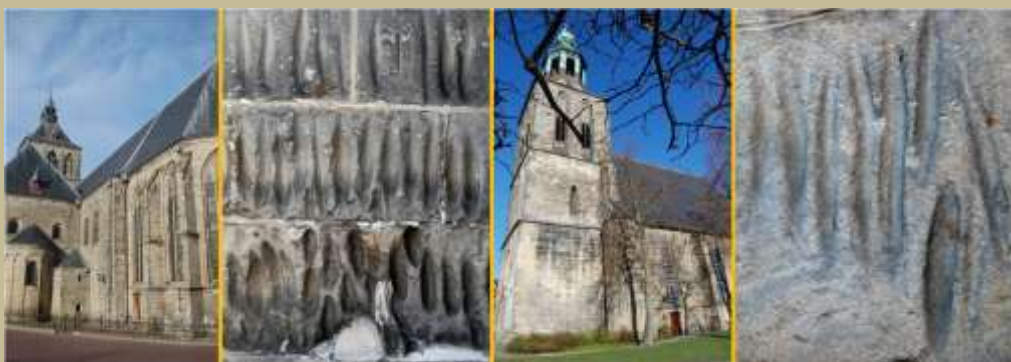
Krabsporen in Bentheimer zandsteen in Oldenzaal (foto 1+2) en in Nordhorn (foto 3+4), Duitsland
